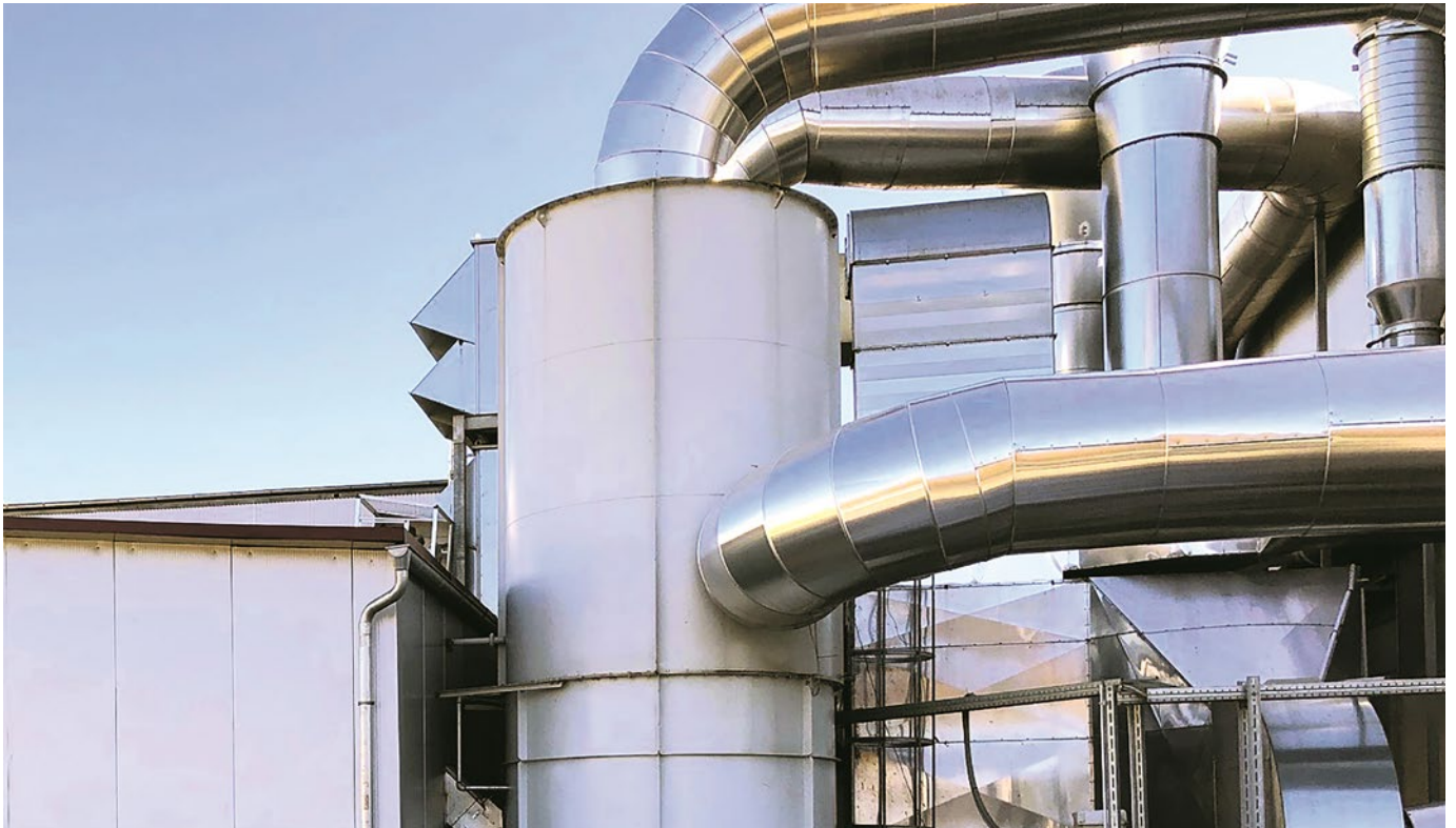
Zentraler Nassabscheider zur Entstaubung von Schleif- und Polieranlagen. Eine End-to-End-Betrachtung von Polierprozessen ermöglicht große Einsparungen.
